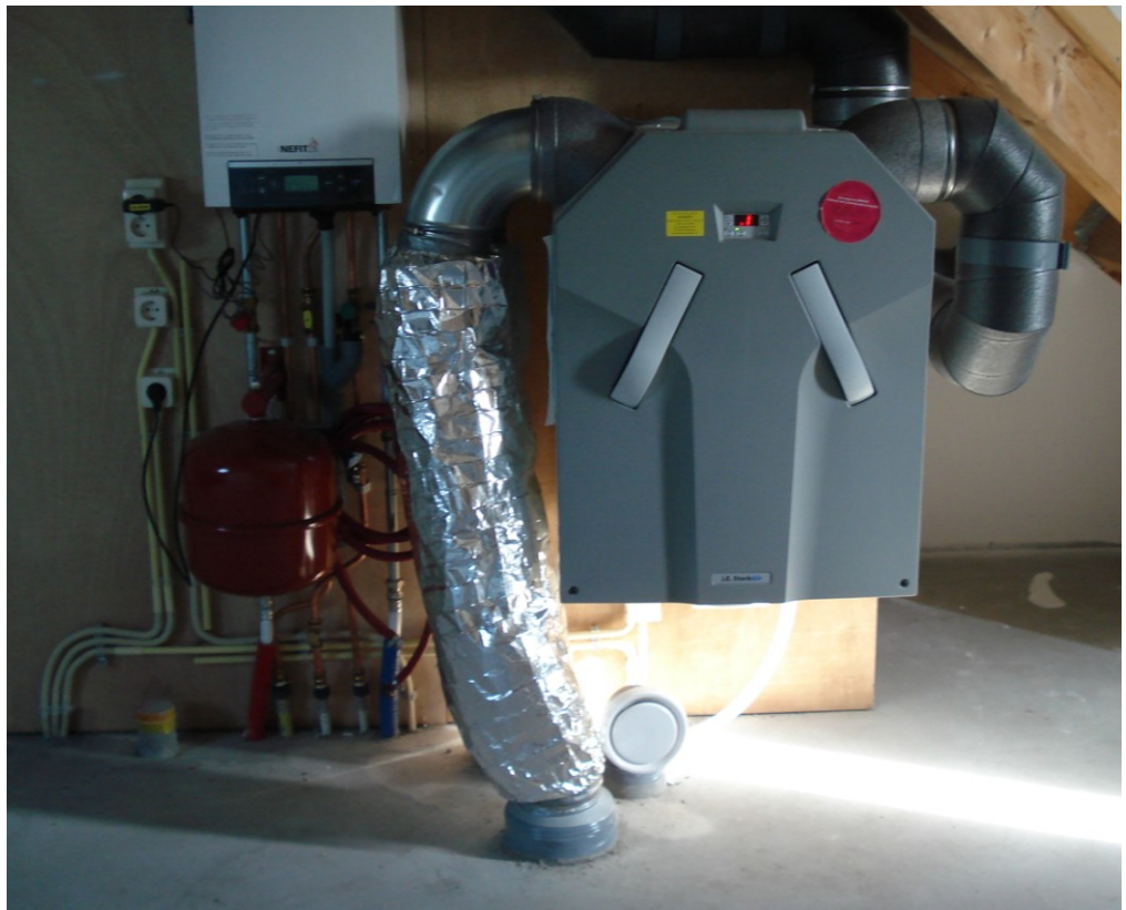
Een gebalanceerd ventilatiesysteem met WTW
