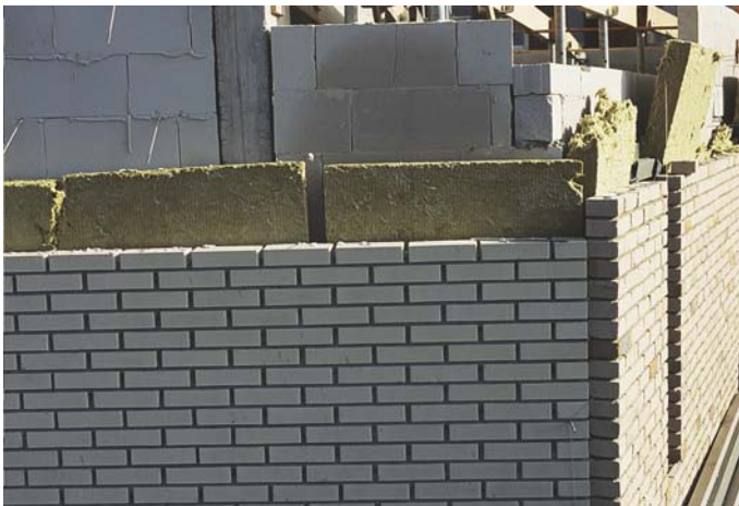
Afb. 5.22 Zorgvuldige uitvoering voorkomt energieverlies. Op de foto is duidelijk zichtbaar dat de isolatieplaten niet op elkaar aansluiten waardoor een ernstig warmtelek zal ontstaan.
