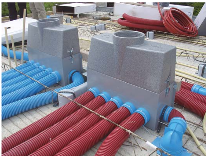
Afb. 6.4 Twee luchtverdeelkasten bij een gebalanceerd ventilatiesysteem, de ene voor de toevoerlucht (met de blauwe kanalen), de andere voor de afvoerlucht (met de rode kanalen). In de verdeelkast worden de luchthoeveelheden ingeregeld. Dit heeft als voordeel dat men niet-regelbare ventielen voor toe- en afvoer gebruikt die dus niet onregelbaar kunnen worden bij bijv. het schoonmaken door bewoners. In de verdeelkasten, die deels in de (beton)vloer aangebracht zijn, kunnen geluiddempers worden ingebouwd. De verdeelkasten moeten bereikbaar blijven voor inspectie en onderhoud. (Bron: Burgerhout BV)
