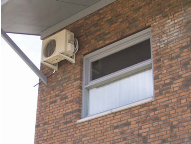
Afb. 8.4 Een split-unit heeft een tochttrisiko en ontsiert de gevel
