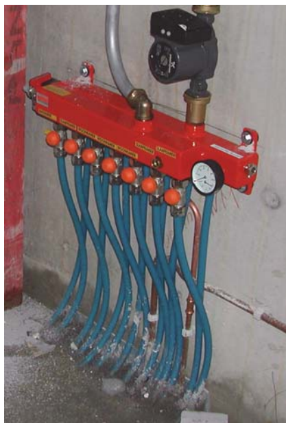
Afb. 7.12 Een verdeler met inregelvoorzieningen en afsluiters. De verdeler is nog niet voorzien van warmte-isolatie, maar dit is zeker aan te bevelen
