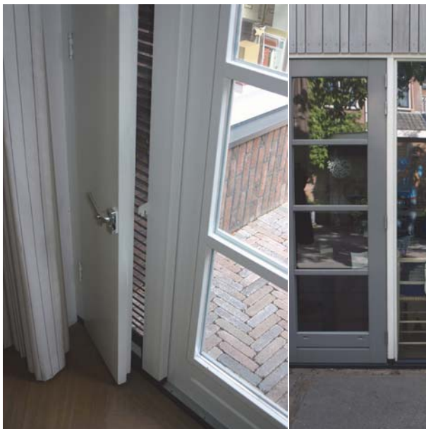
Afb. 6.22 Voorbeeld van een voorziening voor zomernachtkoeling in een woning te Zeist. In de gevel van de woonkamer zijn 2 inbraakvrije ventilatieroosters ( 2 \times 0,25 \times 2 \text{ m} = 1 \text{ m}^2 ) met een isolatieluik aangebracht; een dakraam zorgt voor een goede natuurlijke trek. (Betrokken partijen: Architect ii studio, realisatie Ettekoven Annemer & interieurbouwer, advies BOOM-SI; realisatie 2009. Foto's: Joost Ettekoven)
