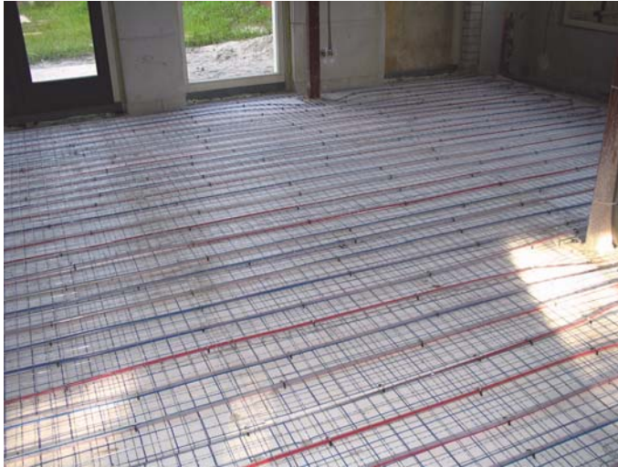
Afb. 8.2 Het afgiftesysteem voor vloerkoeling is hetzelfde als voor vloerverwarming. Een systeem met direct een isolatielaag er onder reageert veel sneller dan een systeem zonder die isolatie (zie ook paragraaf 7.2.3). Op de foto moet de dekvloer nog worden aangebracht
