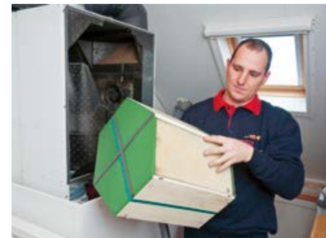
Warmtewisselaar, uitgenomen voor controle en reiniging bij onderhoud.
