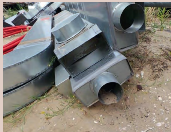
Niet-afgesloten kanalen worden vies op de bouw.
