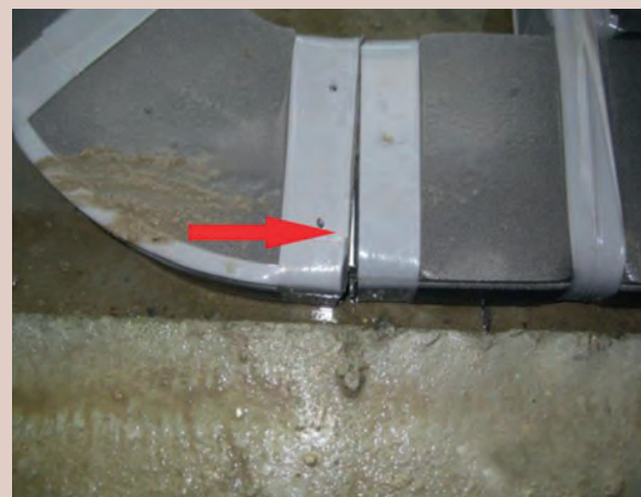
Voorbeeld van niet goed uitgevoerde aansluiting, waarbij geen luchtdichting is verzorgd.
