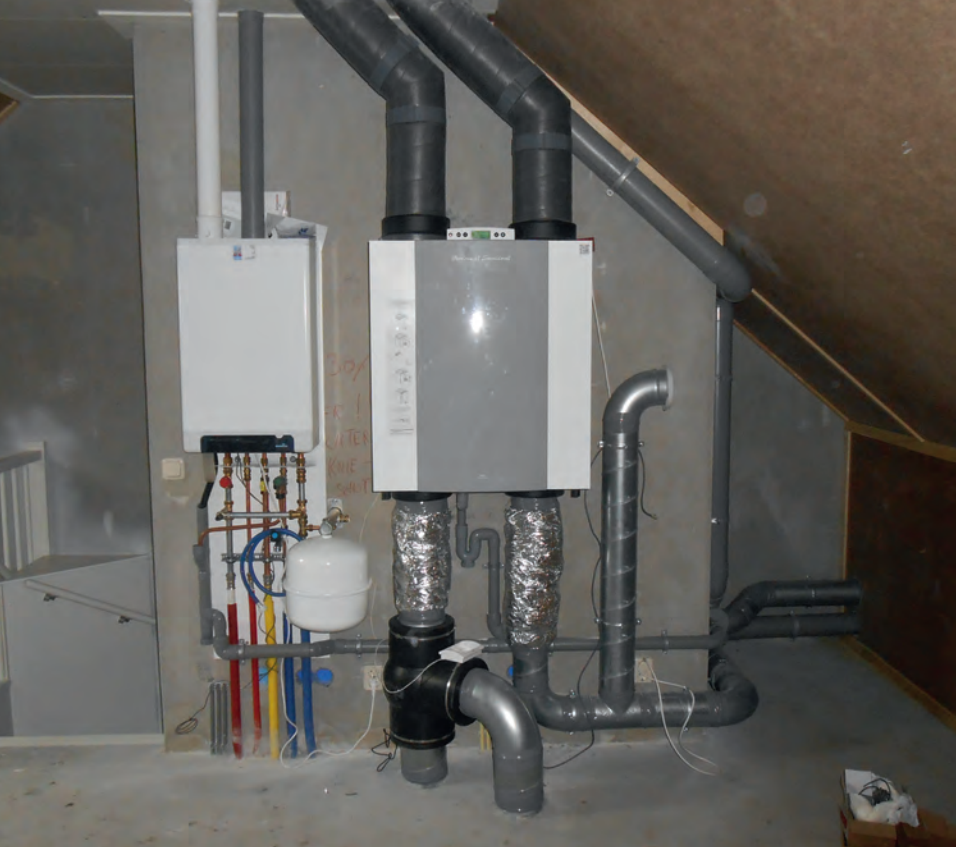
Een open opstelling op zolder kan onder voorwaarden. Hier is de unit gemonteerd op een zware wand en is er volop ruimte voor kanalen.
