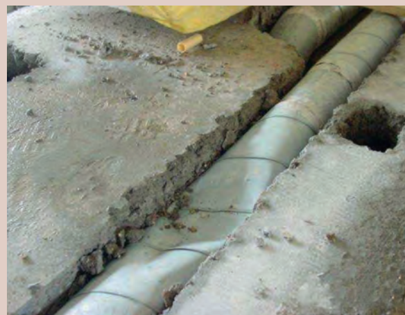
Een ingedeukt kanaal, dat kan een keer gebeuren. Harm Valk: “Als dan de betonwagen voor de deur staat, is de neiging om toch maar af te storten. Doe dat niet, want het is nooit meer te herstellen. De betonwagen moet dan maar even wachten: het kanaal moet worden vervangen. Dit moet je nooit instorten, want je komt er niet meer bij. Het ventilatiesysteem is direct verknalt als je dat wél zou doen.”
